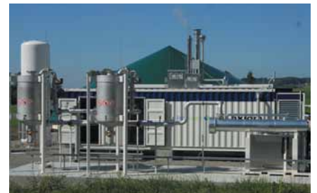
Die Anlage der Bebra Biogas GmbH in Kißlegg im Allgäu.
