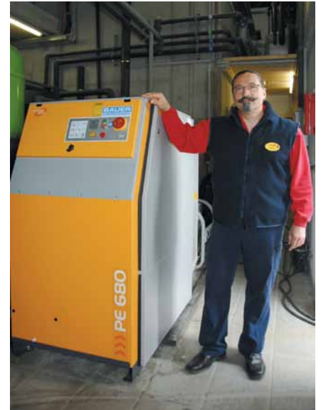
BAUER-Verdichter für die Luftversorgung.
