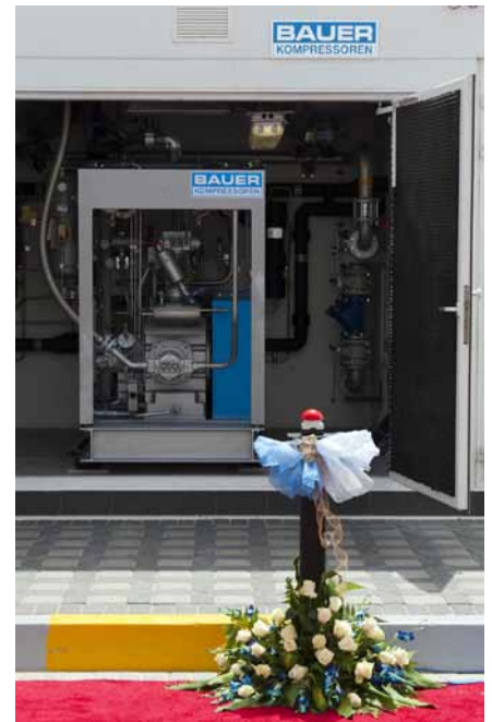
BAUER Erdgastankstelle in Abu Dhabi kurz vor der Einweihung.
